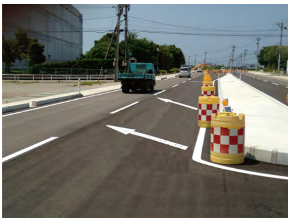
施工イメージ(実績写真) 矢印板との並行利用で車線絞り込みが可能です。
